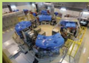
陽子線治療装置(主加速器シンクロトロン)
