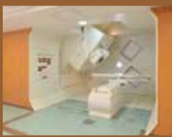
陽子線治療装置 (回転ガントリー照射室)
